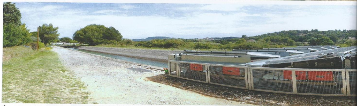
▲ Aperçu du prototype Canalsol de centrale solaire installé sur le canal de Provence.
