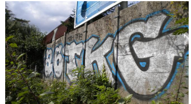
Identifier et traiter les secteurs dégradés
